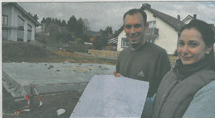
Seit Monaten warten Dunja und Nils Schwarz bereits darauf, auf der Bodenplatte ihr Haus errichten zu können. (Foto: Reinnarth)
