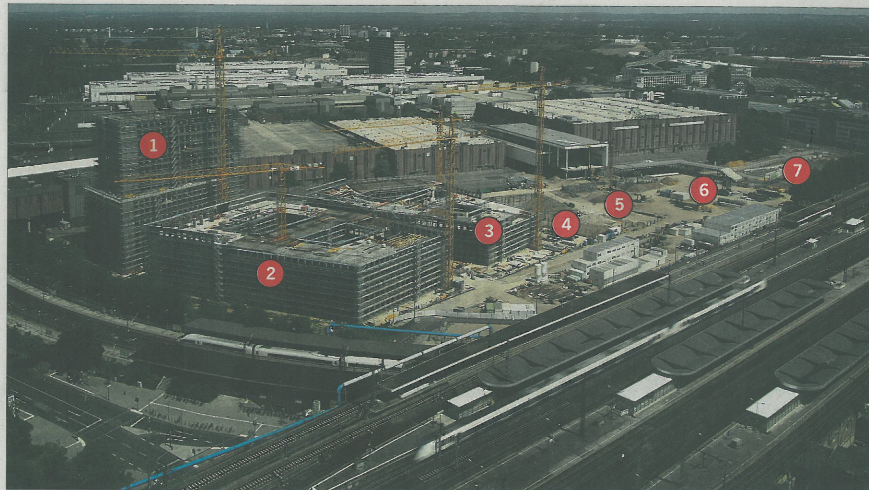
Großbaustelle zwischen dem Bahnhof Messe/Deutz (im Vordergrund) und der Messe (hinten): Dort wächst das Büroviertel Messecity. (Foto: Messecity)
